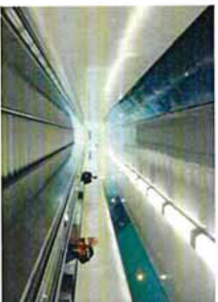
Rolltreppen zum Fußgänger- und Fahrradtunnel (Quelle: Planersocietal)
